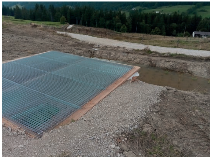
Filtre à sable
