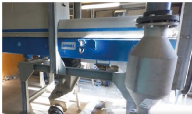
Centrifugeuse de la station de Versonnex
