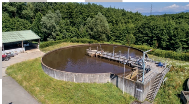
Station de Divonne les Bains
