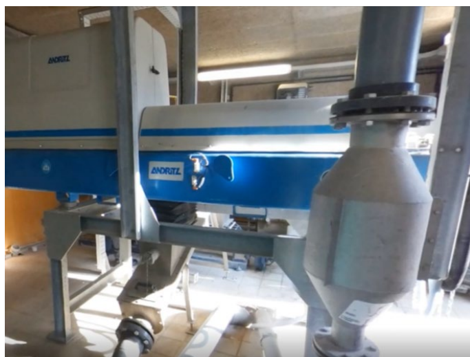
Centrifugeuse de la station de Veronnex
