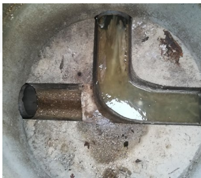
DO entrée de la station d'épuration de Chezery
