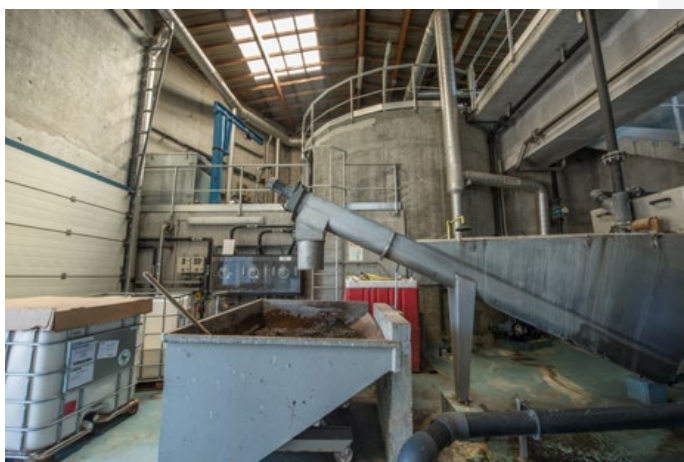
Dessableur de la station de Divonne les Bains
